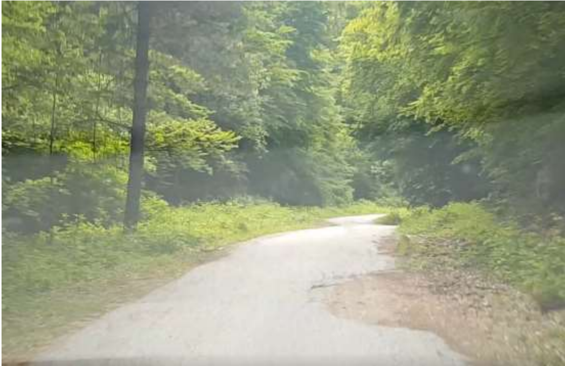
Fotografia 2 (Gjendja e rrugës ekzistuese lokale)
