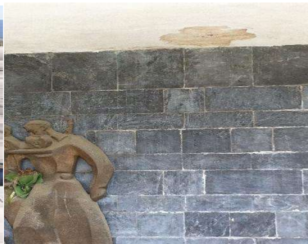
Слика 14 Оштетен плафон
