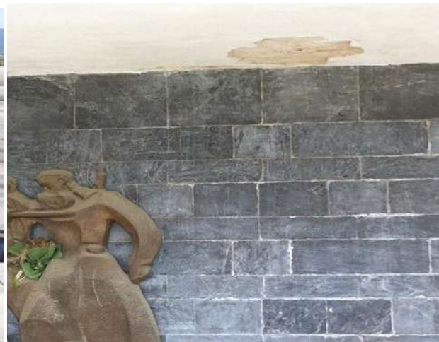
Слика 14 Оштетен плафон
